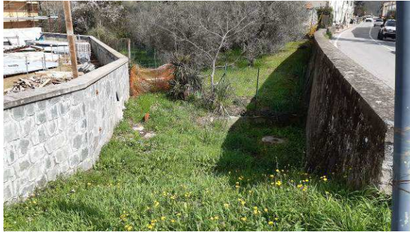
A SIN NUOVO MURO. A DEST MURO SOSTENGNO SEDE STRADALE. LA FASCIA TRA I DUE MURI E' OCCUPATA DAL FOSSO TOMBATO
